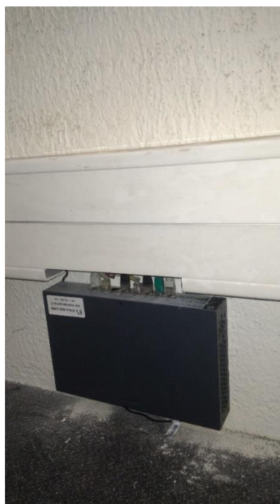
Annexe 3 : Commutateur manageable HP 8 ports installé à l'atelier de la maintenance
