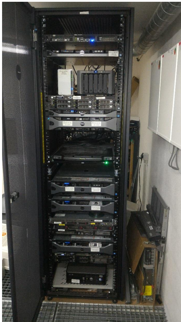
Annexe 1 : Baie de serveur physique dans lequel sont installés les serveurs virtuels
