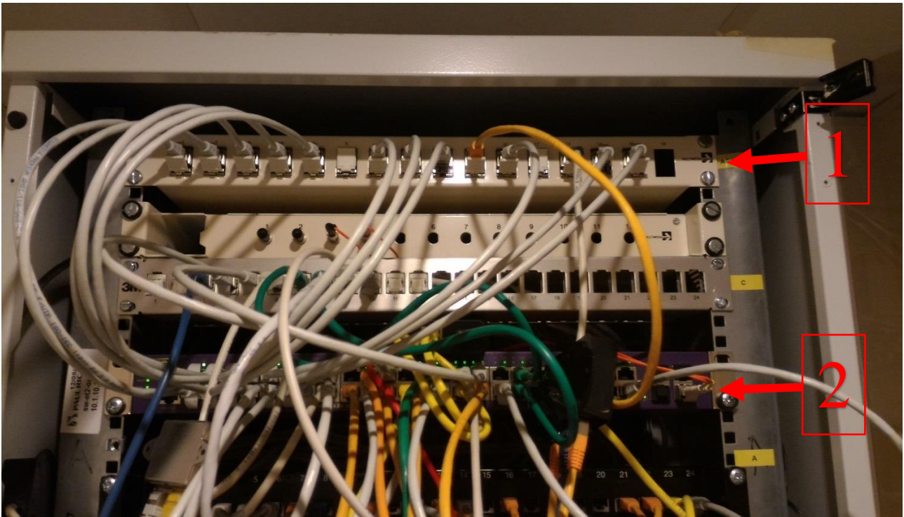
Figure 3 : Baie de brassage (1) avec commutateur Extreme Networks (2)
